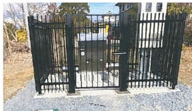
【新たに設置された十八引増圧ポンプ場】
