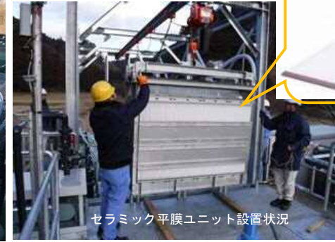
錦織浄水場ろ過膜設置状況
