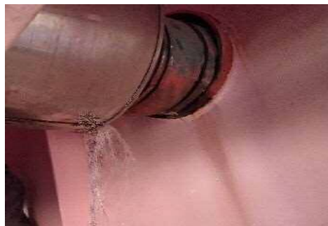
【中埠橋水管橋漏水状況】
