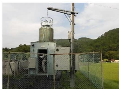
【馬の足加圧ポンプ場】
