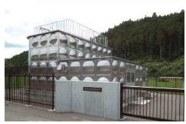
米川増圧ポンプ場
