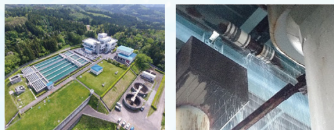
老朽化した施設や管路
