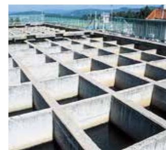
5 フロック形成池 水の中の汚れの粒子は、この池をゆっくりと流れながら、しだいに大きなフロックとなります。 ※フロックとは凝集剤などを添加したことにより生じる汚れのかたまりです。
