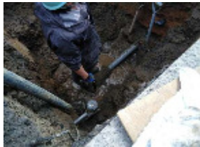
【漏水している様子】
