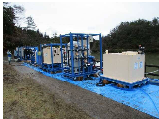
断水復旧までの間、特殊な装置により溜池から汲み取った水を、飲用に適した水に浄化しています
