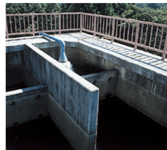
3 着水井(ちやくすいせい) 浄水場に到着した水は、最初にこの池に入ります。ここでは水の濁り具合など、水質の状況を確認し、次の混和地での薬品注入量などを決めます。
