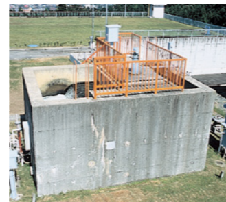
4 混和池(こんわち) この池では、汲み上げられた水に含まれる不純物(汚れの粒子)同士をまとめて沈みやすくするため凝集剤(ポリ塩化アルミニウム)を入れ攪拌します。
