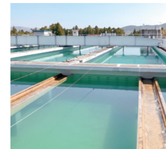
6 沈殿池(ちんでんち) 大きくなったフロックは、この池を約5時間かけてゆっくりと進みながら徐々に沈んでいきます。そして、きれいになった上澄み水はろ過池へ送られ、沈んだフロックは濃縮槽へ送られます。
