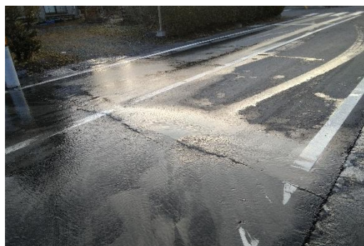
図 5-5 地震による漏水被害
