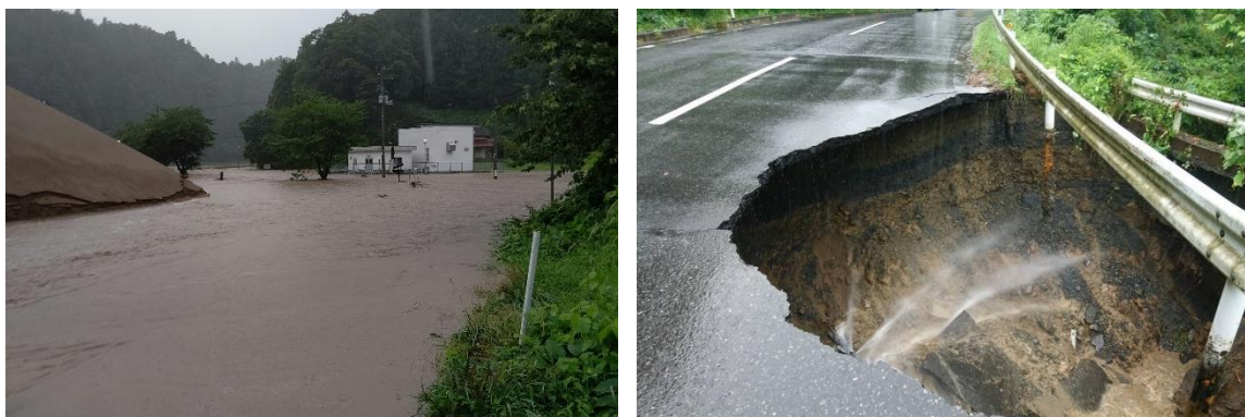
図表 46 浸水する米谷浄水場と道路陥没による管露出
