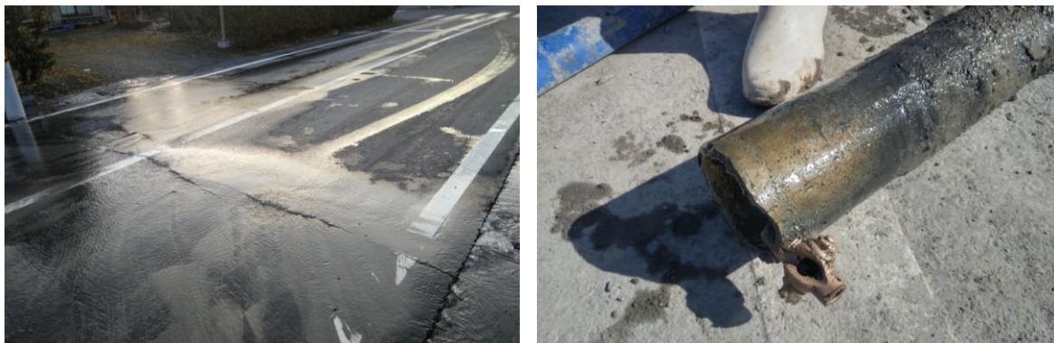
図表 45 福島県沖を震源とする地震による漏水被害（登米町）
