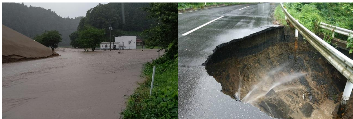
図表 16 浸水する米谷浄水場と道路陥没による漏水
