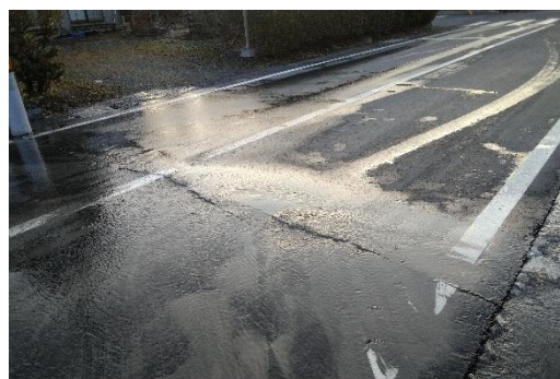
図表 15 地震による漏水被害
