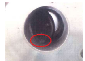
【逆止弁に挟まった異物】
