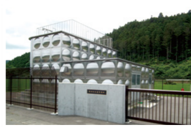
米川増圧ポンプ場
