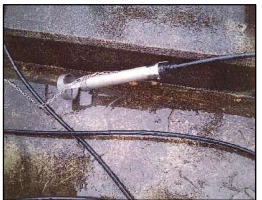
【故障した水位計】
