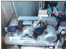
【異常が発生したコンプレッサー】
