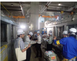
【膜ろ過設備見学の様子】
