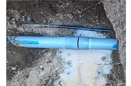
漏水箇所（接合部の割れ）
