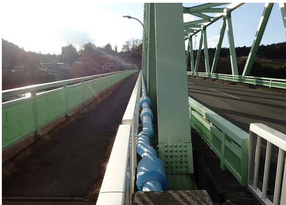
連絡管 (米谷大橋に設置)
