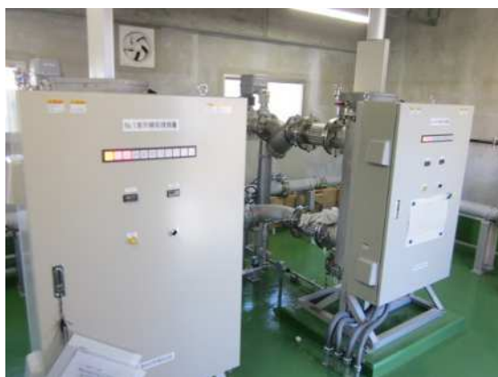
紫外線処理設備
