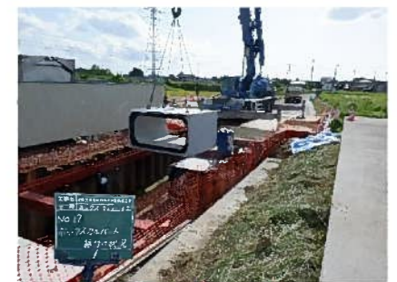
【浄化槽整備状況】
