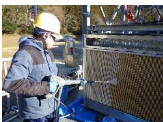
【膜ろ過装置を洗浄している様子】
