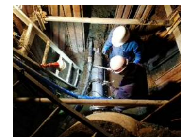
【災害復旧の状況】
