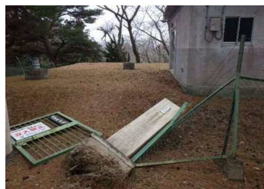
【大岳配水池門扉倒壊の状況】
