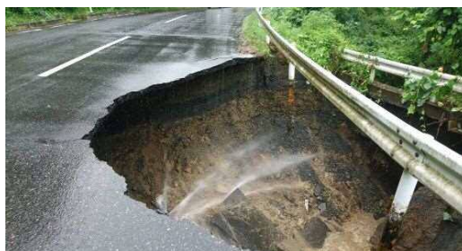
【配水管が破断し、漏水している様子】
