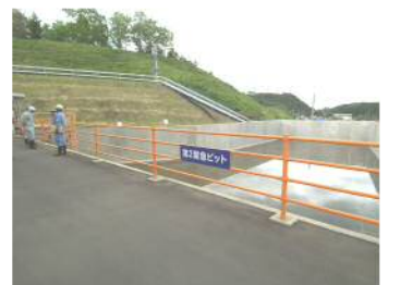
昨年整備した廃水ピット
