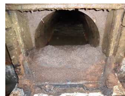
樋管（φ800mm）土砂堆積状況
