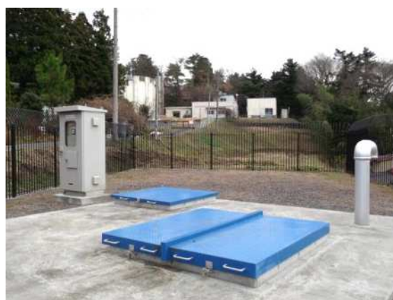
緊急遮断弁設置場所
