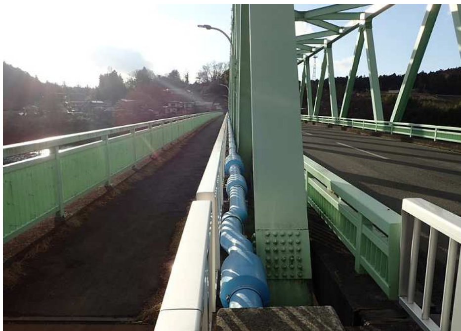
連絡管 (米谷大橋に設置)
