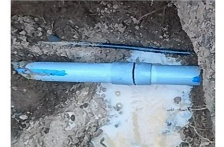
漏水箇所（接合部の割れ）
