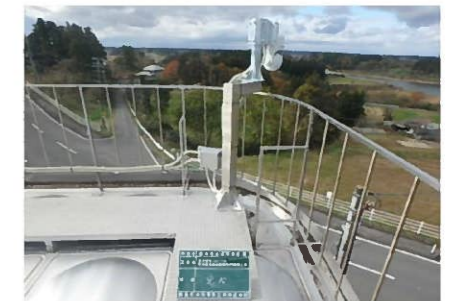
新たに設置した監視カメラ
