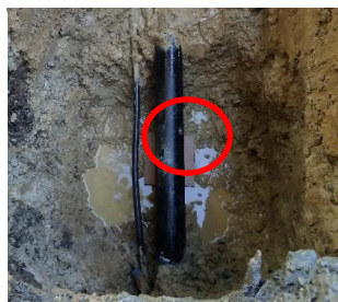
【漏水箇所(穴あき)の状況】
