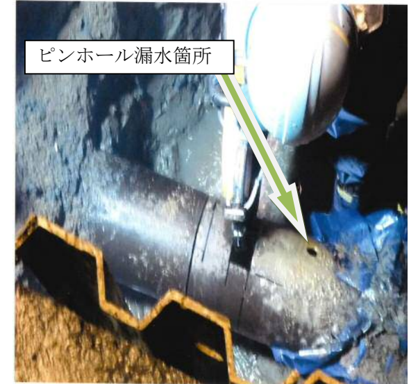
漏水したφ250mm水道管の状況
