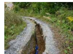
土石流により道路が洗掘され配水管が露出している様子
