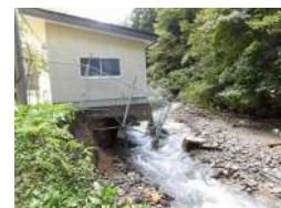
大綱木浄水場の基礎部が洗掘している様子
