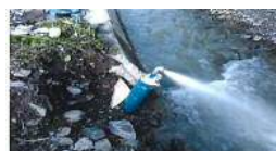
水管橋が破断し漏水している様子
