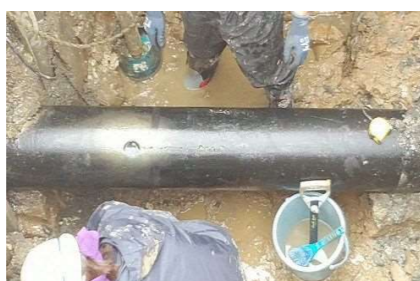
【漏水箇所（穴あき）状況】
