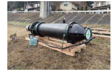
2号取水ポンプ(全景)
